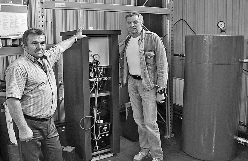
Внутренний блок климат-системы совсем небольшой и полностью автоматизирован
