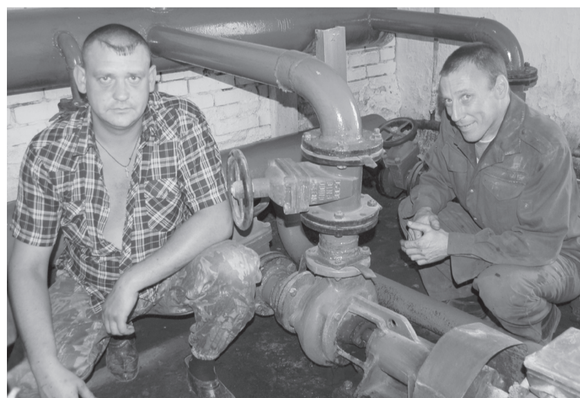
Оператор котельной Сергей Байкалов и сварщик Павел Маликов проверяют готовность оборудования
